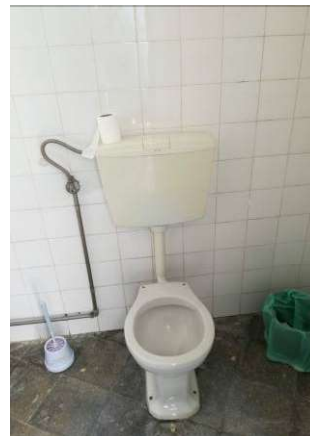
Louça sanitária degradada
