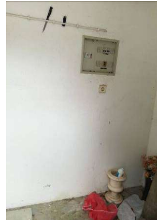
Arrumo (com quadro eléctrico)
