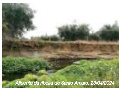
Erosão de taludes e margens e assoreamento do leito
