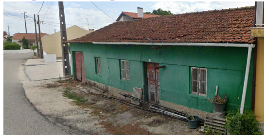
Figura 37: Imóvel degradado e devoluto na Rua de São João
