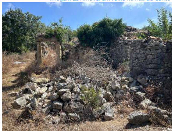
Imagem 23: Imóvel em ruína na Rua do Canto
