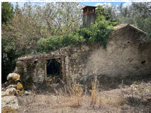
Imagem 22: Imóvel em ruína na Travessa das Pregueiras
