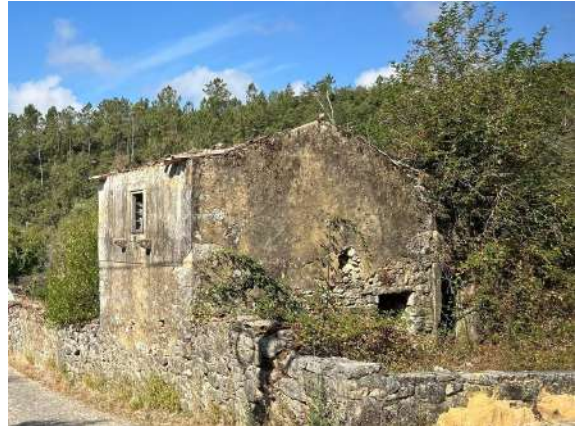
Imagem 43: Imóvel degradado e devoluto na Rua das Lajes
