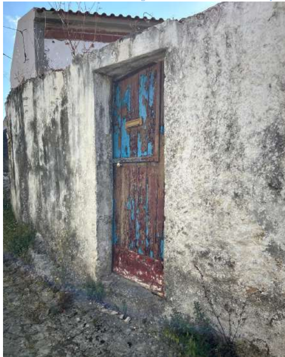
Imagem 51: Imóvel na Rua das Lajes
