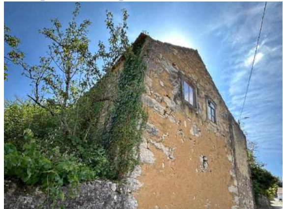
Imagem 45: Imóvel degradado e devoluto na Rua da Soeira
