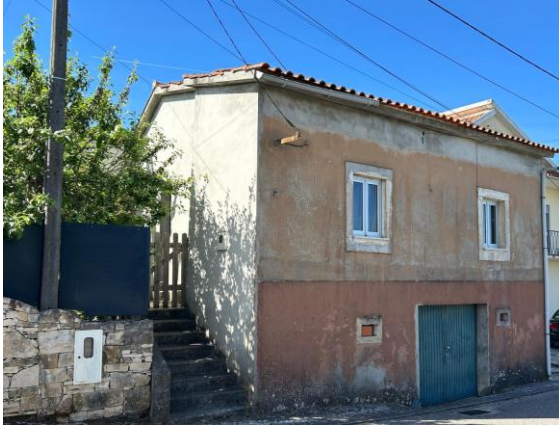
Imagem 43: Imóvel degradado e devoluto na Rua das Escolas
