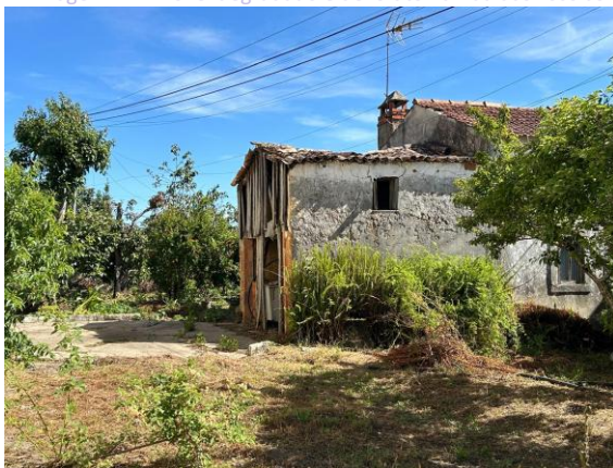
Imagem 41: Imóvel degradado e devoluto na Rua das Escolas
