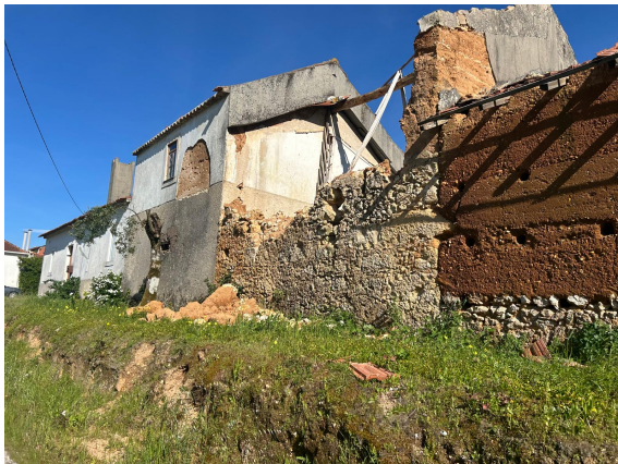
Figura 2: Imóvel degradado na travessa da Bela Vista
