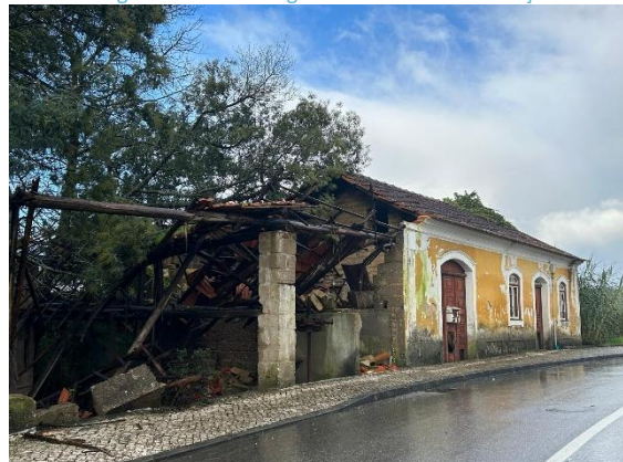
Imagem 3: Edifício degradado na rua dos Serviços Sociais
