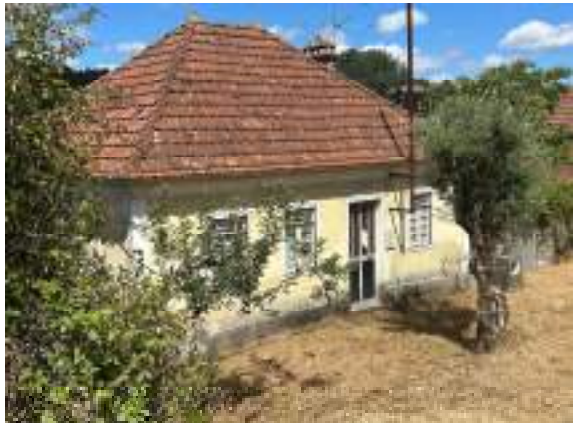
Imagem 29: Imóvel em mau estado de conservação e devoluto na rua da Ribeirinha
