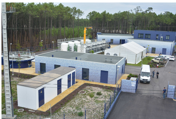
Foto n.º I - Estação de Tratamento de Água
