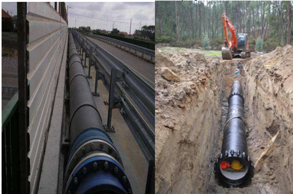
Foto n.º I- Obras de execução da conduta adutora em ferro fundido dúctil DN 600mm
