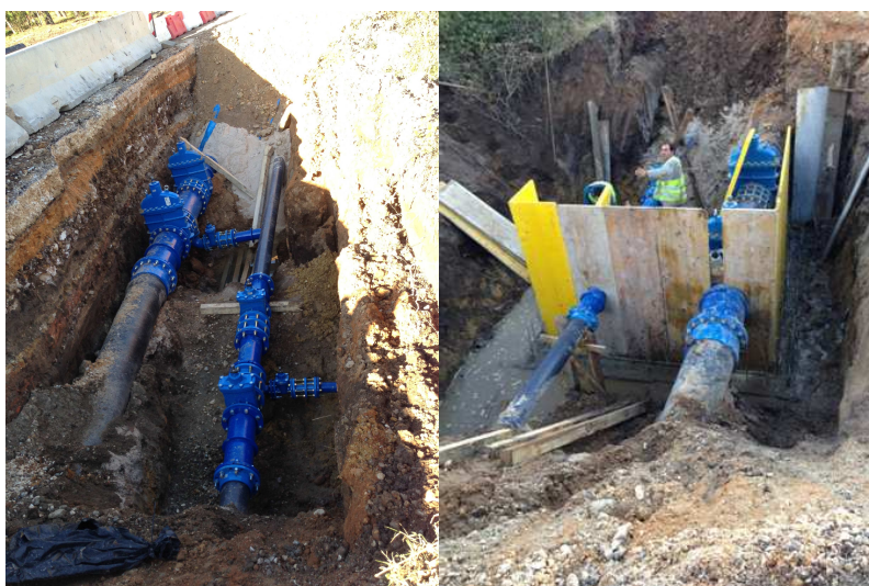
Foto n.º II- Obras de execução das condutas que permitem a ligação das novas infra-estruras às já existentes
