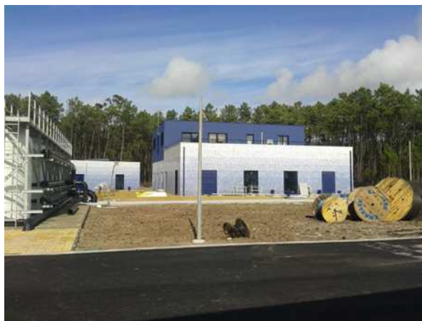
Foto n.º III- Estação de Tratamento de Água em fase de construção
